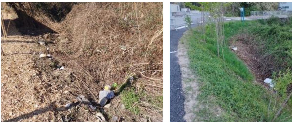
Figure 10 : Fossés non entretenus, envahis par la végétation et les déchets © C. PLATEL
